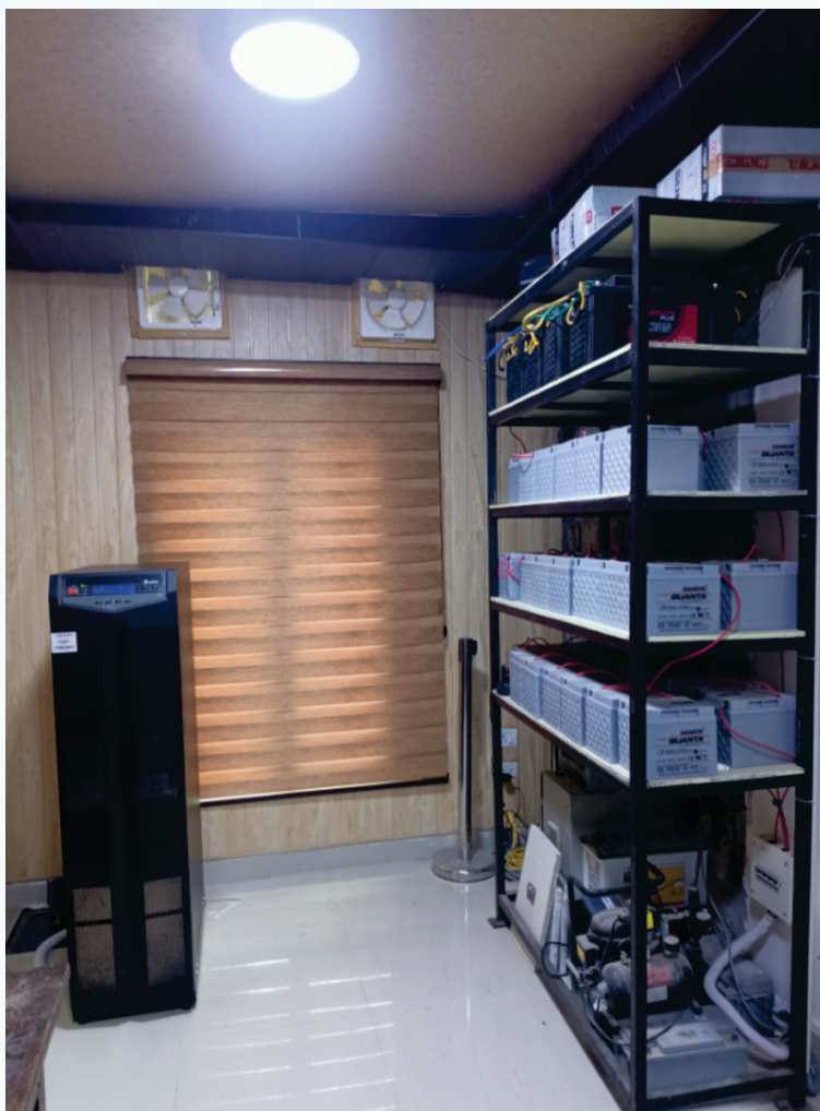
आकृति 49. इलेक्ट्रॉनिक्स प्रयोगशाला में स्थापित 20kVA UPS प्रणाली।
